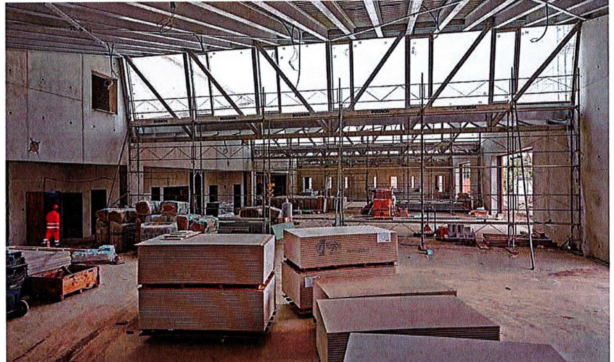
Für die Ausbildung der Maurer und Plattenleger wird es vier unterteilbare Hallen geben.
